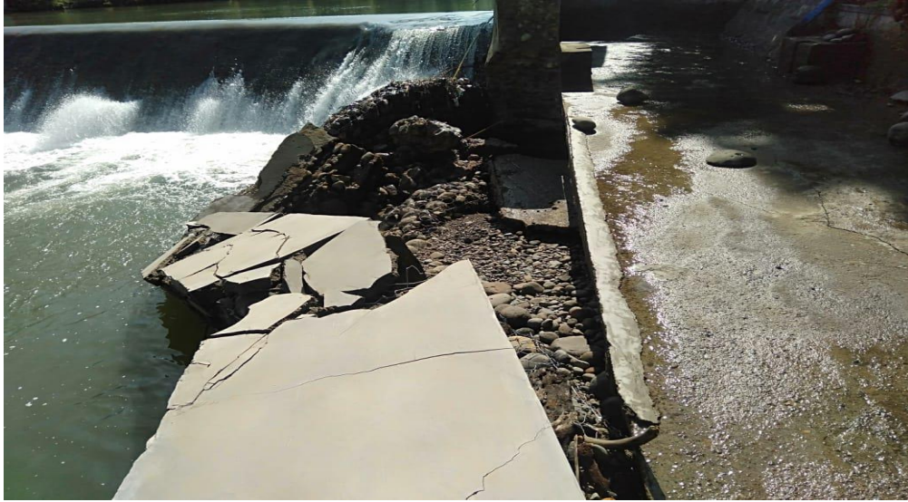
Gambar 1. 2 Kerusakan Saluran Irigasi Sebelah Kiri
