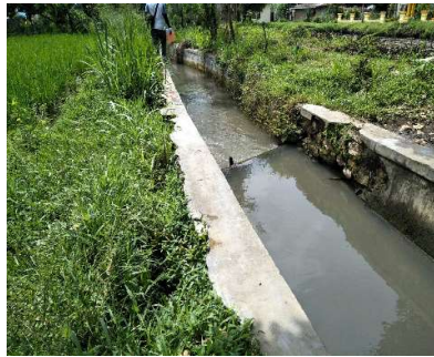
Gambar 1 .1 Kerusakan Saluran BSD 11 -12 ( Sumber: Dokumentasi 2022)
