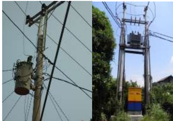
Gambar 2.8 Gardu Tiang Tipe Cantol dan Portal
