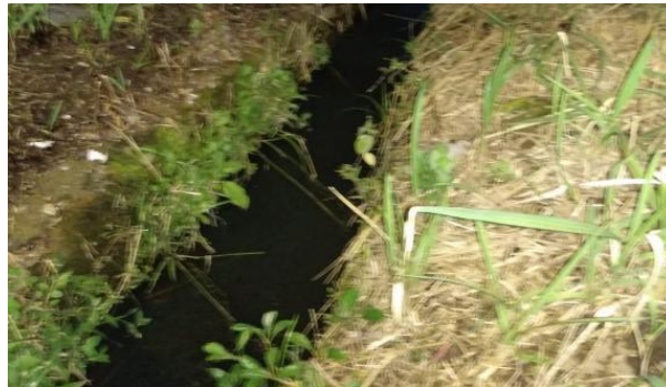
Gambar 1.1 Drainase di Jalan Belanti (Sumber : Survey Lapangan 14 Januari 2020)
