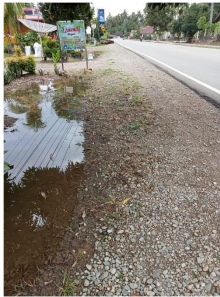
Gambar 1.1 Jalan Raya Taratak belum adanya saluran drainase
