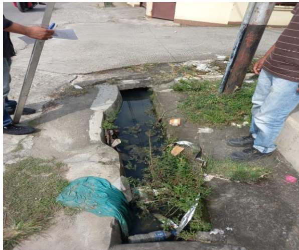
Gambar 1. 2 Kondisi Drainase dilapangan
