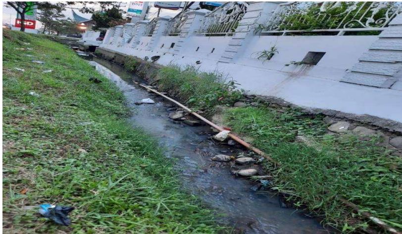
Gambar 1. 3 Kondisi terkini saluran drainase kawasan Universitas Baiturrahmah (sumber : dokumentasi pribadi, 19/07/2022)
