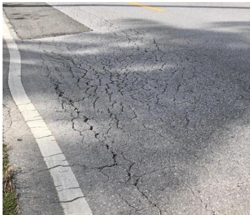
Gambar 1.3 Retak Buaya ( Alligator Cracks ) (Sumber : Dokumentasi Pribadi, 2022)
