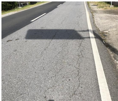
Gambar 1.1 Kerusakan Retak Memanjang (Sumber : Dokumentasi Pribadi, 2022)
