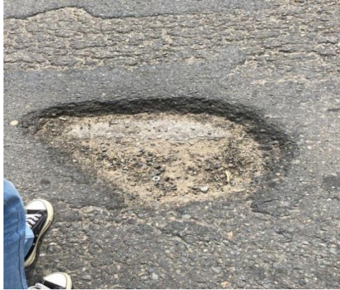
Gambar 1.2 Kerusakan Lubang (Potholes) (Sumber : Dokumentasi Pribadi, 2022)
