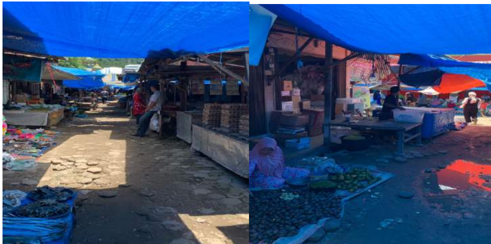
Gambar 6. Kondisi Lantai Pasar Bila Hujan Air Tergenang
