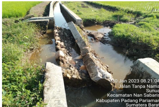
Gambar 1.1 Kondisi Kerusakan Pada Pintu Air
