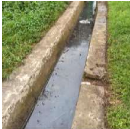
Gambar 2. 1 Kondisi Terkini Saluran Drainase Kawasan Jalan Bypass Lubug Begalung
