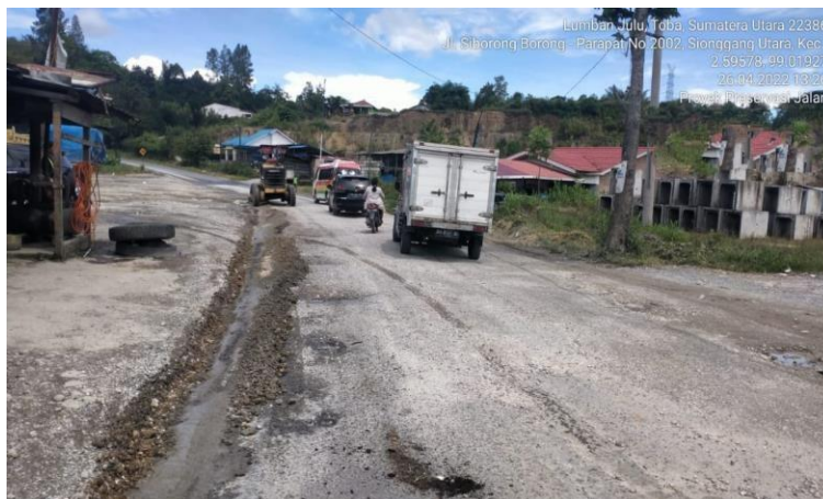
Gambar 1.1 Bahu Jalan Yang Tidak Layak
