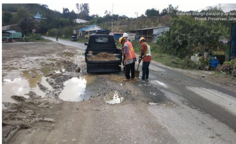
Gambar 1.2 Jalan Berlubang Dan Tambalan
