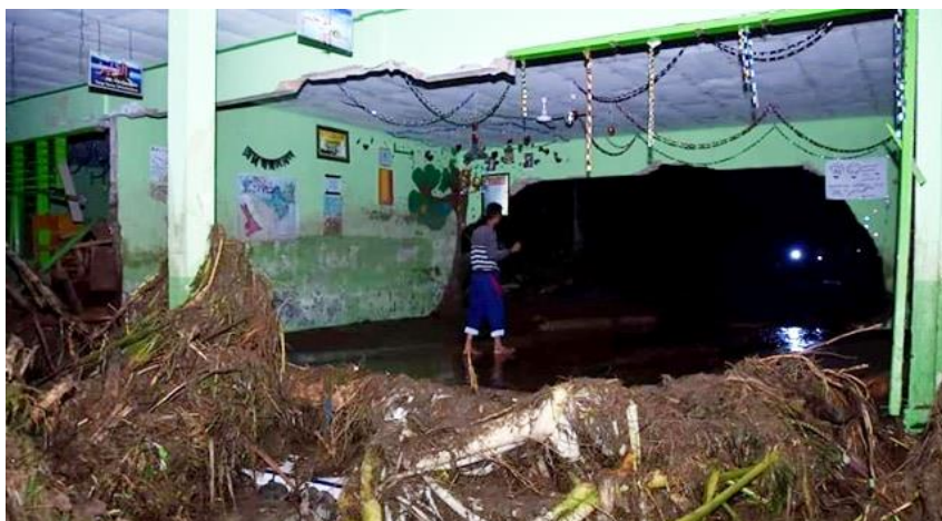
Gambar 1.1 Kerusakan Akibat Banjir di Sungai Batang Bawan
