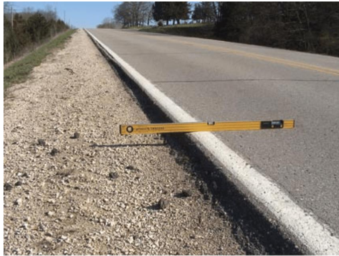
Gambar 2.16. Kerusakan Pinggiran Jalan Vertikal
