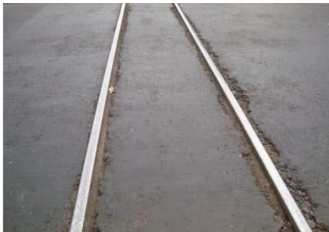
Gambar 2.21. Kerusakan Rusak Perpotongan Rel
