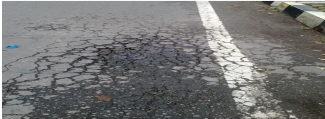
Gambar 2.8. Kerusakan retak kulit buaya
