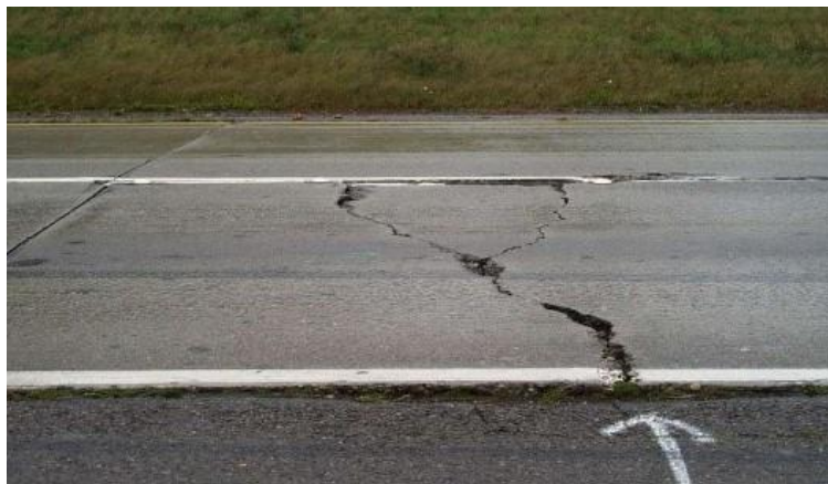
Gambar 2.15. Kerusakan Retak Sambung
