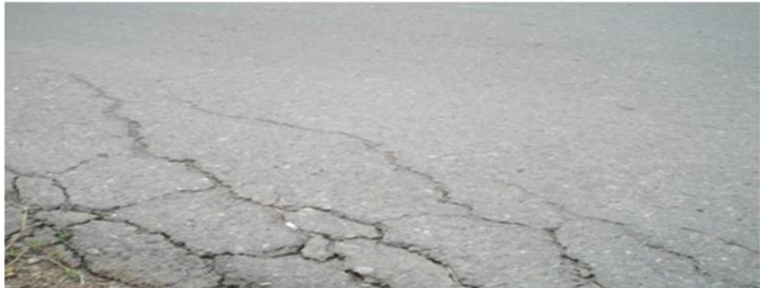
Gambar 2.14. Kerusakan Retak Pinggir
