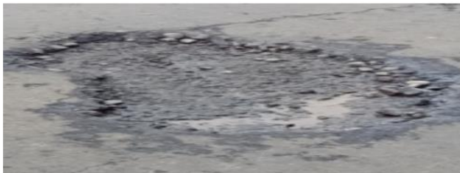
Gambar 2.26. Kerusakan Pelepasan Butir
