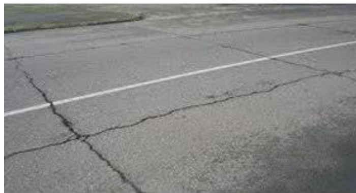
Gambar 2.12 Retak reflektif sambungan ( joint reflection cracks ) (Sumber : Christady Hardiyatmo, 2015)
