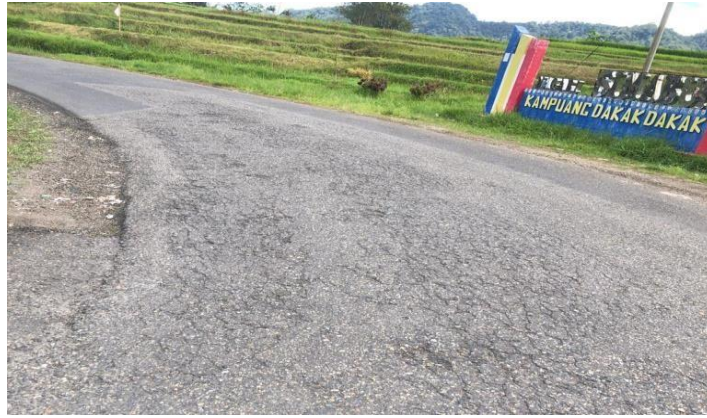
Gambar 2.13 Retak Kulit Buaya ( Alligator Cracks )
