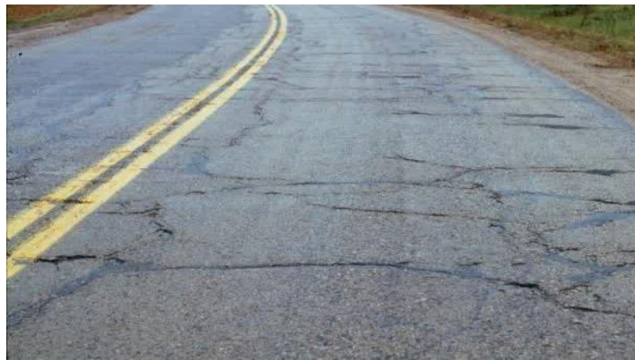
Gambar 2.14 Retak Blok ( Block Cracks )
