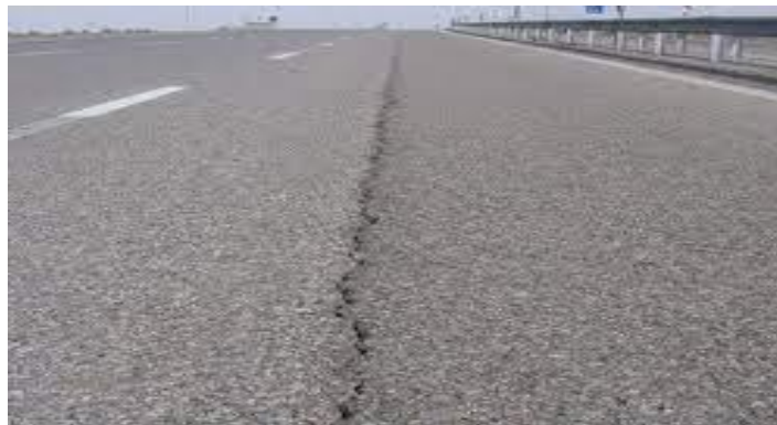
Gambar 2.10 Retak memanjang ( Longitudinal Cracks )
