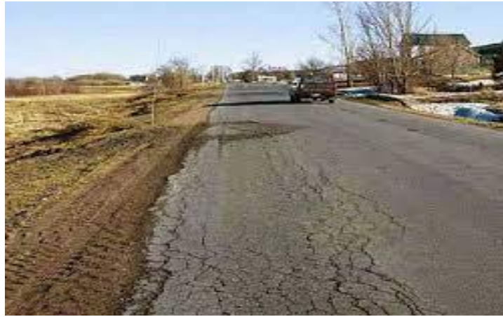
Gambar 2.16 Retak Samping Jalan ( Edge Cracking ) (Sumber : Christady Hardiyatmo, 2015)
