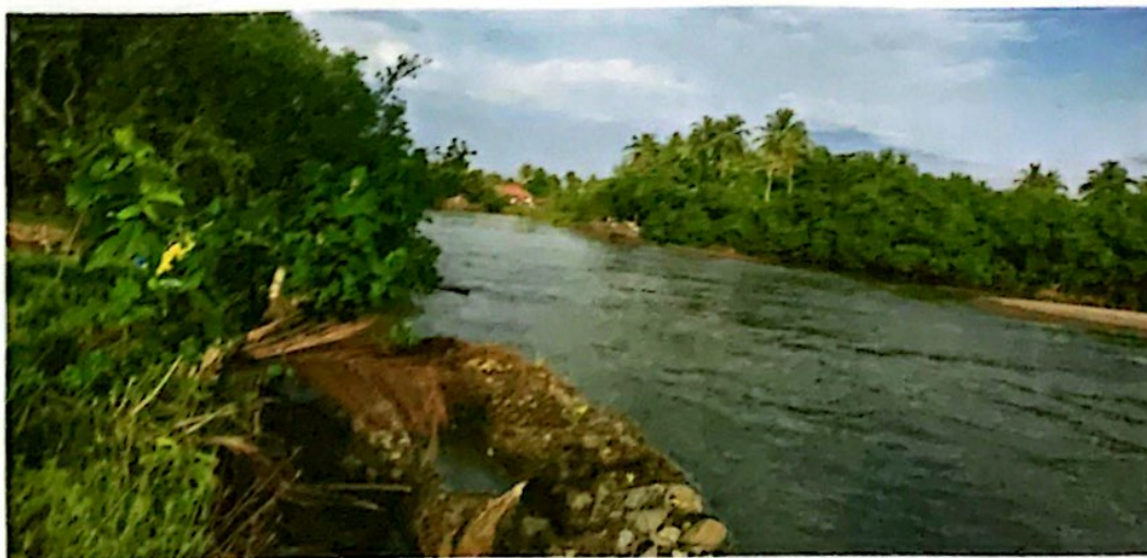
Gambar 1.2 Bronjong Penahan Tanah Rusak (Sumber: Dokumentasi Pribadi)
