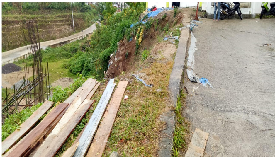
Gambar 1.1 Longsor yang terjadi pada lereng Pulau Anak Aia
