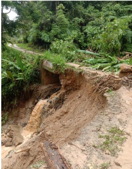
Gambar 1. Bahu Jalan Longsor
