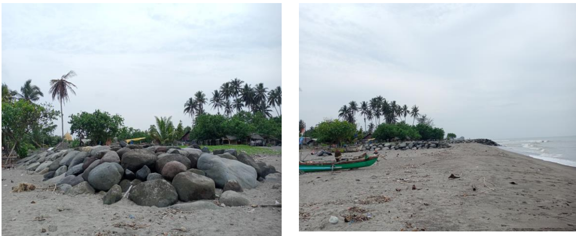
Gambar 1. 1 Keadaan Groin di Pantai Ulakan Tapakis (Sumber : Foto Pribadi)
