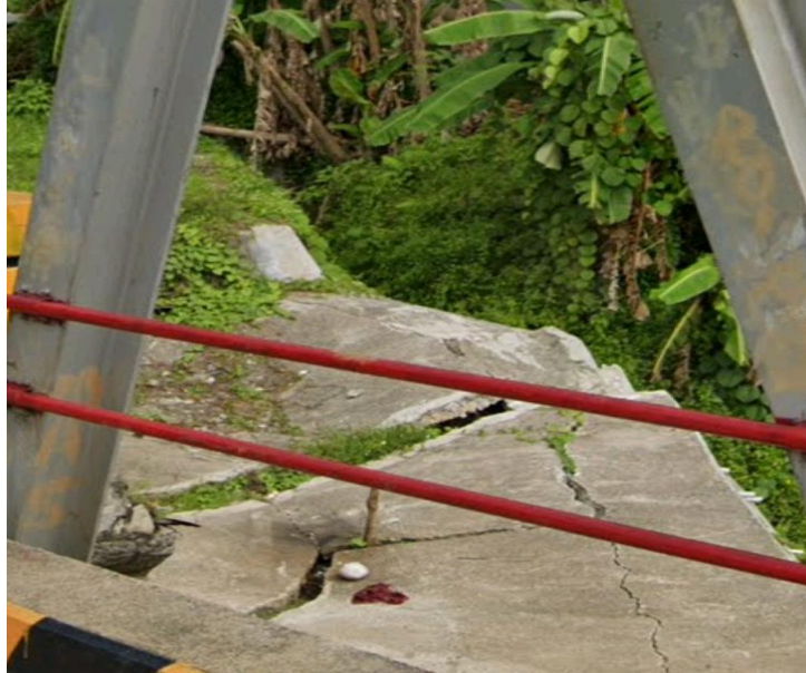
Gambar 1 1 Lokasi keruntuhan lereng di sekitar Oprit jembatan
