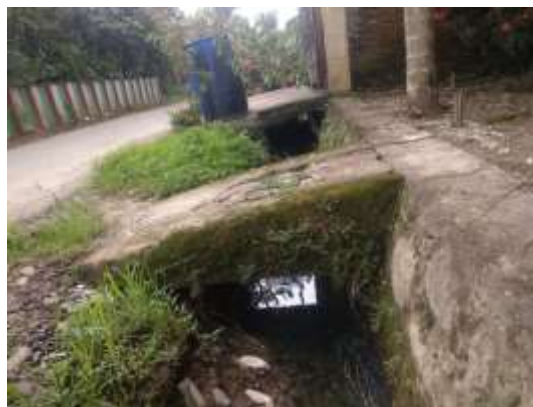
Gambar 1. 2 Drainase yang Bermasalah Sumber: Dokumentasi Pribadi
