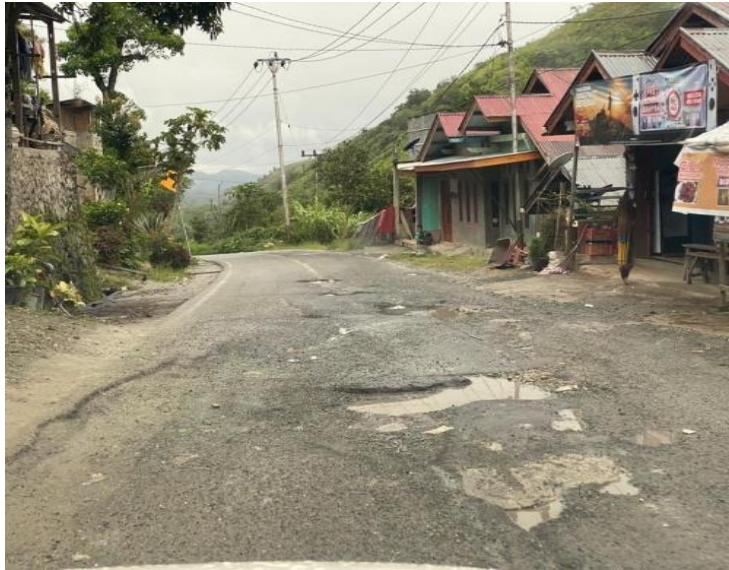
Gambar 1.4 Kondisi Jalan Raya Alahan Panjang-Surian STA 80+500
