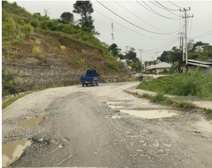
Gambar 1.2 Kondisi Jalan Raya Alahan Panjang-Surian STA 78+700
