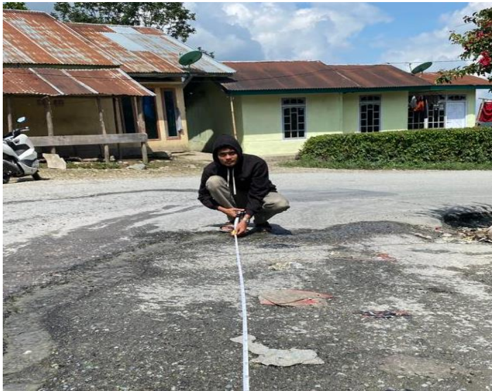
Gambar 1.3 Kondisi Jalan Raya Alahan Panjang-Surian STA 79+500
