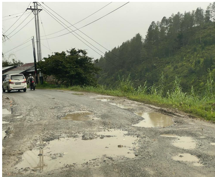
Gambar 1.1 Kondisi Jalan Raya Alahan Panjang-Surian STA 78+500
