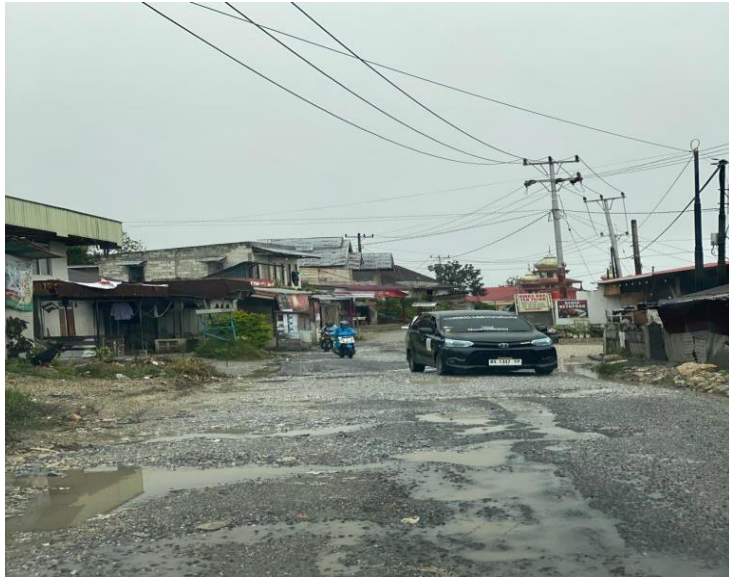
Gambar 1.5 Kondisi Jalan Raya Alahan Panjang-Surian STA 80+900
