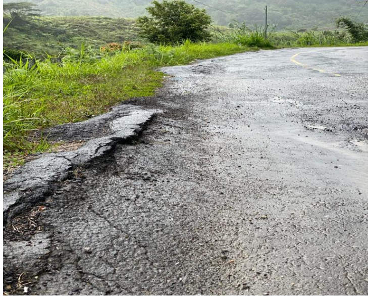
Gambar 1.6 Kondisi Jalan Raya Alahan Panjang-Surian STA 82+100
