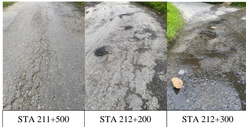
Gambar 1.1 Kondisi Jalan Panti – Simpang Empat
