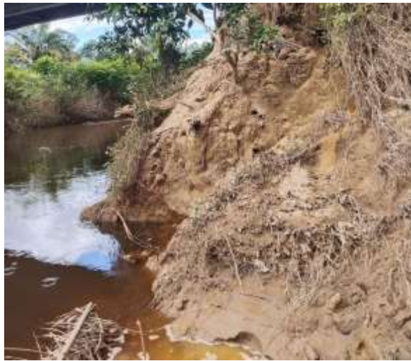
Gambar 1. 1 kondisi lereng dilapangan (sumber: dokumentasi pribadi)
