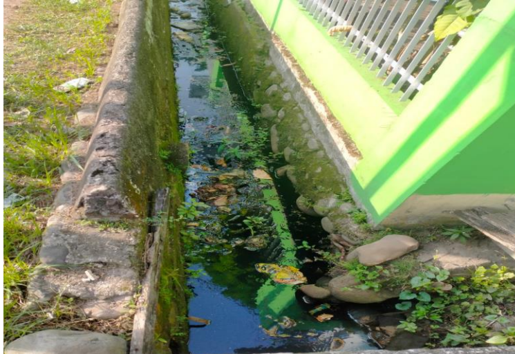
Gambar 1. 2 Kondisi Terkini Saluran Drainase Kawasan Ulak Karang Jalan S Parman (Sumber: Dokumentasi)
