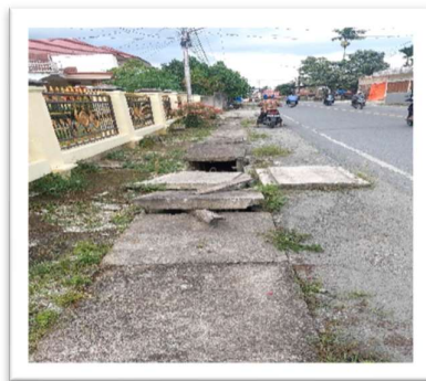
Saluran yang rusak
