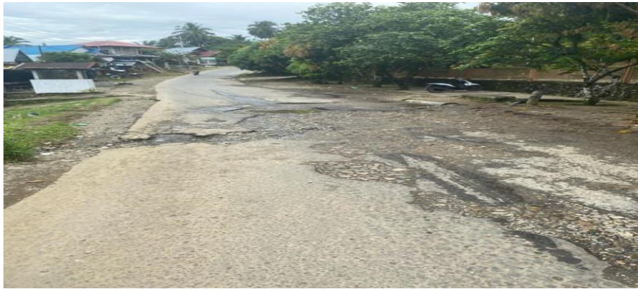
( Gambar 1.1 pelepasan butir yang ada pada STA 263+400)
