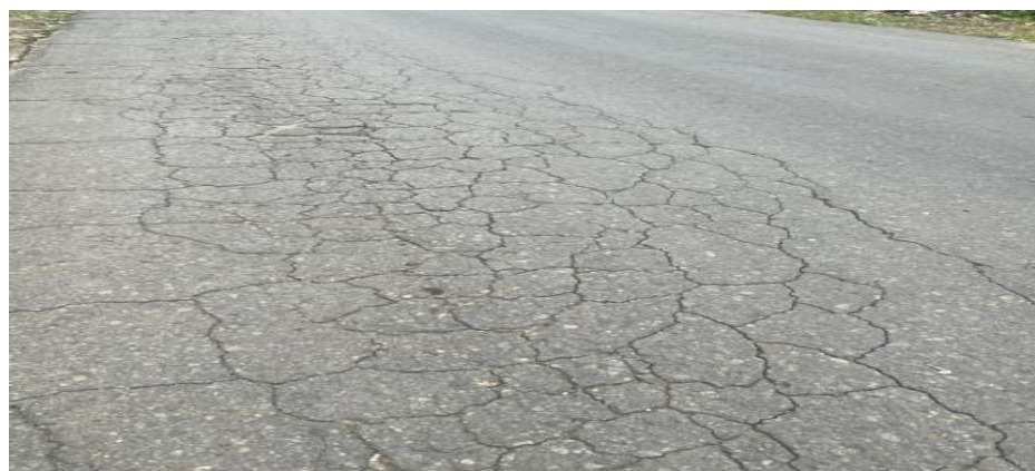
(Gambar 1.2 Retak Kulit Buaya yang ada pada STA 263+100)
