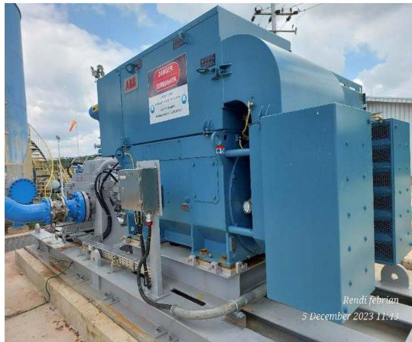
Gambar 2. 2 Motor Penggerak Water Injection Pump area WIP Petani GS (Sumber: Arsip pribadi )
