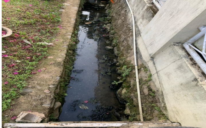
Gambar 1. 2 Kondisi Saluran Drainase perumahan pondok citra lubuk buaya kota padang
