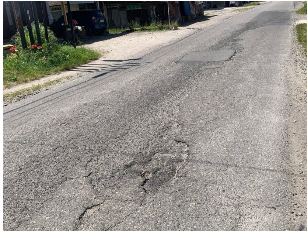
Gambar 1.2 Kondisi Jalan Sicincin – Kurai Taji Km 57+700
