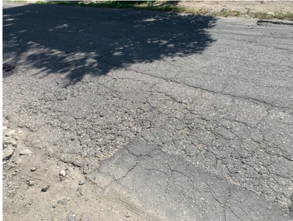
Gambar 1.1 Kondisi Jalan Sicincin – Kurai Taji Km 56+200
