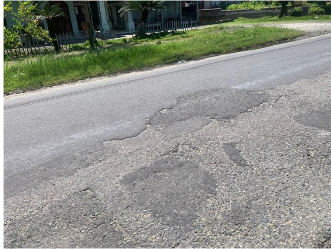
Gambar 1.3 Kondisi Jalan Sicincin – Kurai Taji Km 58+300
