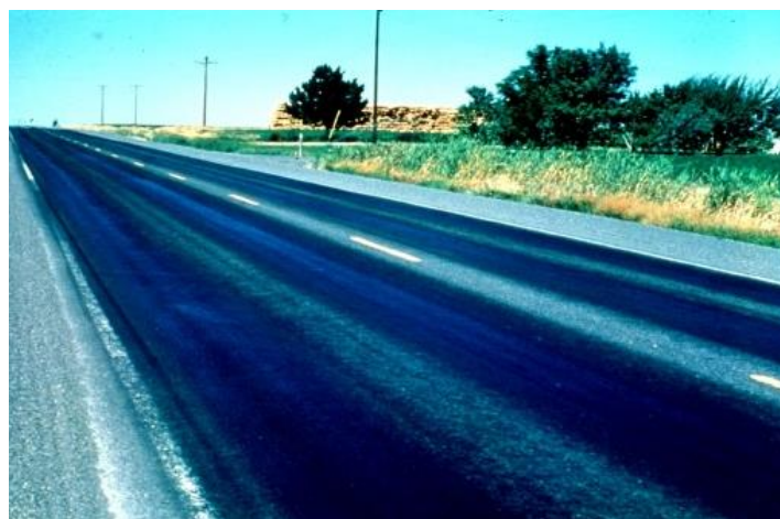
gambar 2. 4 Contoh Kerusakan Kegemukan ( Bleeding )
