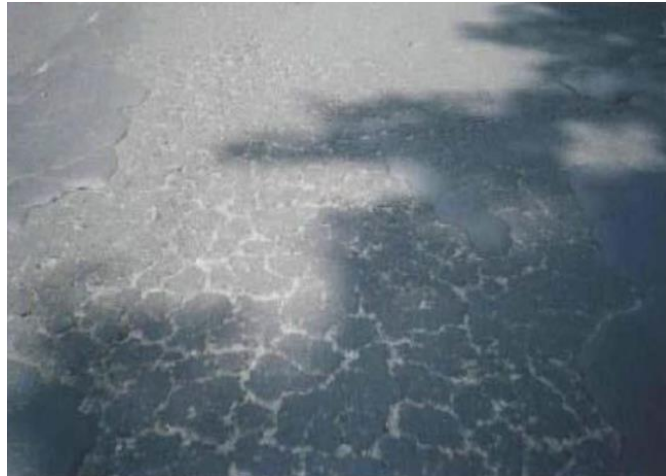
gambar 2. 21 Contoh Kerusakan Pelepasan Butir ( Weathering/Raveling ) (Sumber : Bina Marga no.03/MN/B/1983)
