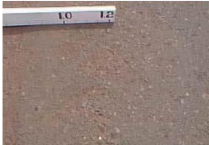
gambar 2. 14 Contoh Kerusakan Pengausan Agregat ( Polised Agregat ) (Sumber : Bina Marga no.03/MN/B/1983)
