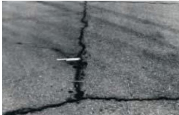
gambar 2. 10 Contoh Kerusakan Retak Sambung ( Joint Reflec Cracking ) (Sumber : Bina Marga no.03/MN/B/1983)
