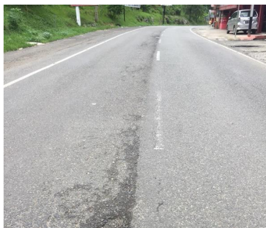
gambar 2. 12 Contoh Kerusakan Retak Memanjang/Melintang ( Longitudinal/Trasverse Cracking )
