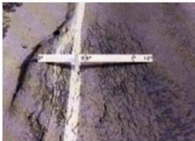
gambar 2. 18 Contoh Kerusakan Sungkur ( Shoving )
