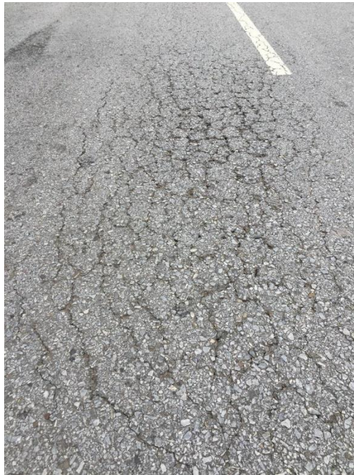
gambar 2. 3 Contoh Kerusakan Retak Kulit Buaya ( Aligator Cracking )
