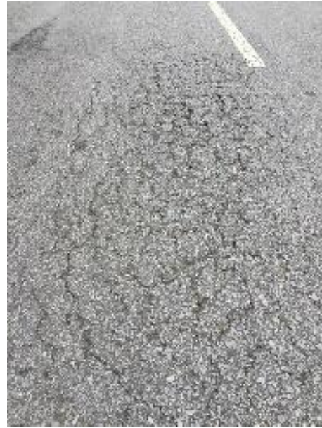
Gambar 4. 3 Kerusakan Retak Kulit Buaya
