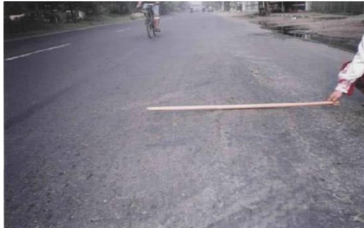
gambar 2. 20 Contoh Kerusakan Mengembang Jembul ( Swell ) (Sumber : Bina Marga no.03/MN/B/1983)
