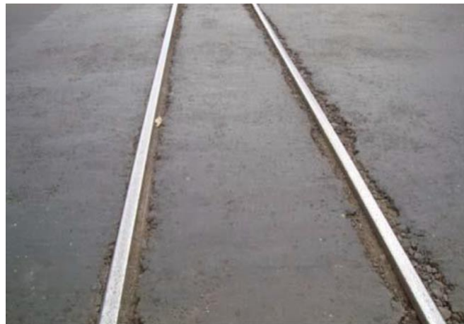
gambar 2. 16 Contoh Kerusakan Rusak Perpotongan Rel ( Railroad Crossing )
