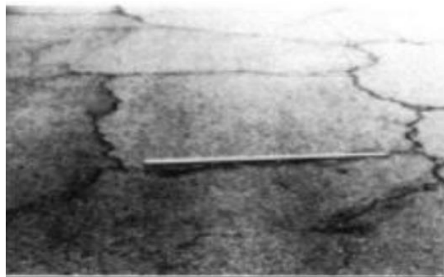
gambar 2. 5 Contoh Kerusakan Retak Kotak-kotak ( Block Cracking )
