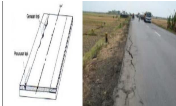
gambar 2. 9 Contoh Kerusakan Retak Samping Jalan ( Edge Cracking ) (Sumber : Bina Marga no.03/MN/B/1983)
