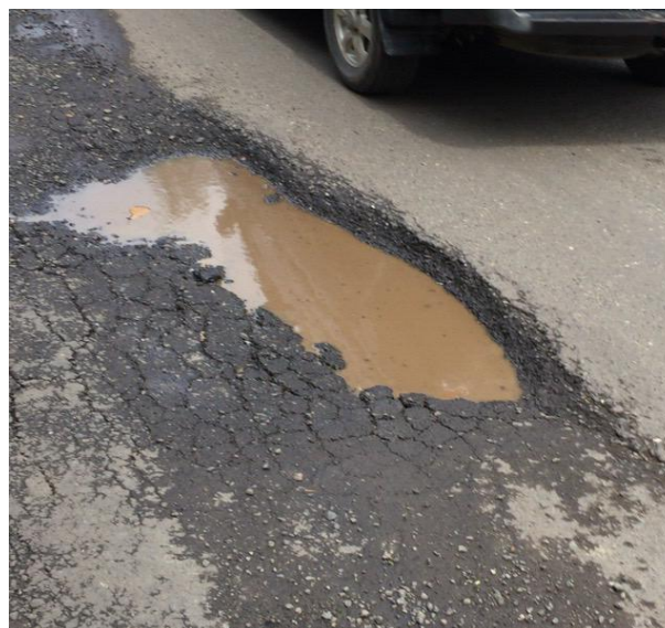
gambar 2. 15 Contoh Kerusakan Lubang ( Pothole )
