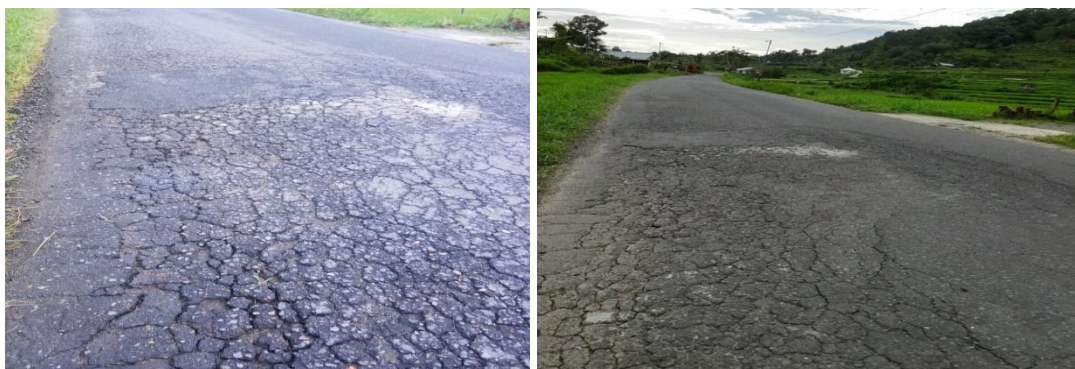
a. Retak kulit buaya Sta 155+140
