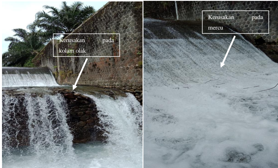
Gambar 1.1 Kondisi Kerusakan pada Bendung
