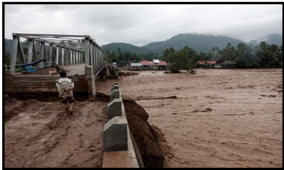
Gambar 1.2. Kerusakan Abutmen dan Ofrid Jembatan yang terban
