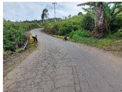
b. Retak kulit buaya Sta 183+200
