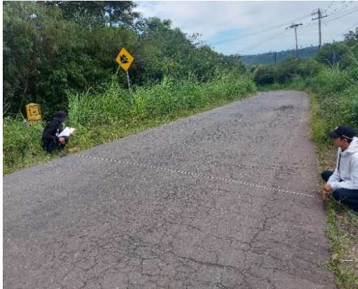
a. Retak kulit buaya Sta 180+000
