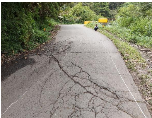
a. Retak melintang Sta 183+900
