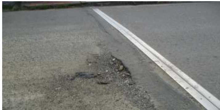
Gambar 2.10. Kerusakan Expansion Joint Jembatan Sebarang Padang 2
