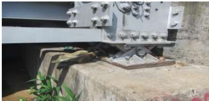
Gambar 2.12. Kerusakan Tumpuan Jembatan Lb.Buaya Bt.Kandis
