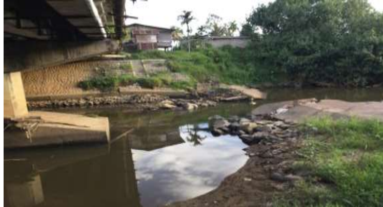
Gambar 2.1. Kerusakan Pada Bangunan Pengaman Jembatan Duku II B
