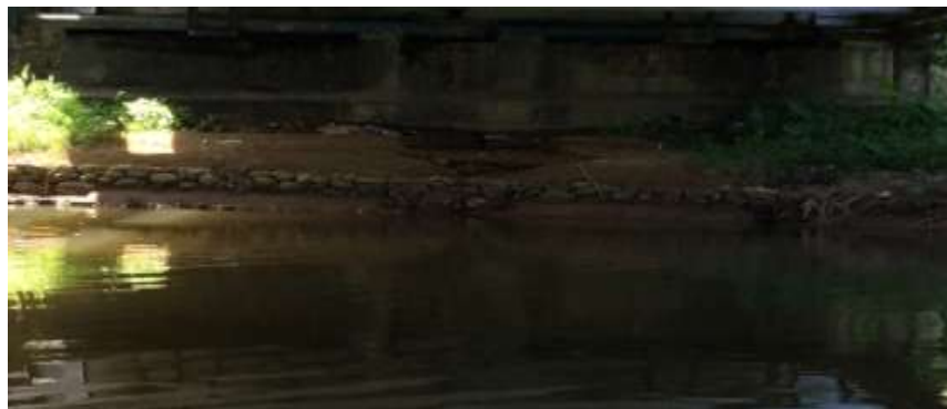
Gambar 2.2. Kerusakan Pada Bangunan Pengaman Jembatan Lubuk Buaya 2
