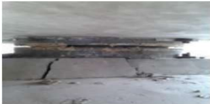
Gambar 2.13. Kerusakan Tumpuan Jembatan Siti Nurbaya
