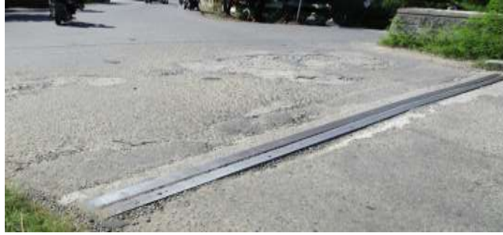
Gambar 2.11. Kerusakan Expansion Joint Jembatan Banuaran
