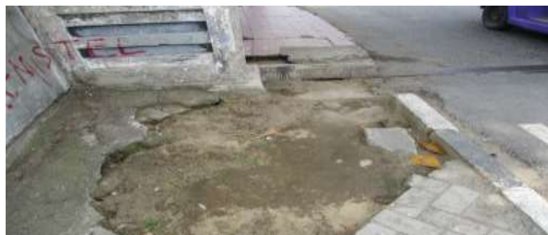
Gambar 2.14. Kerusakan Pada Trotoar Jembatan Purus 1
