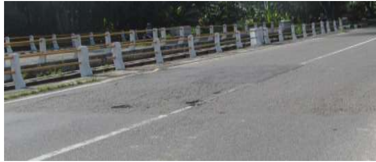
Gambar 2.4. Kerusakan lantai Jembatan Muara Kasang 2
