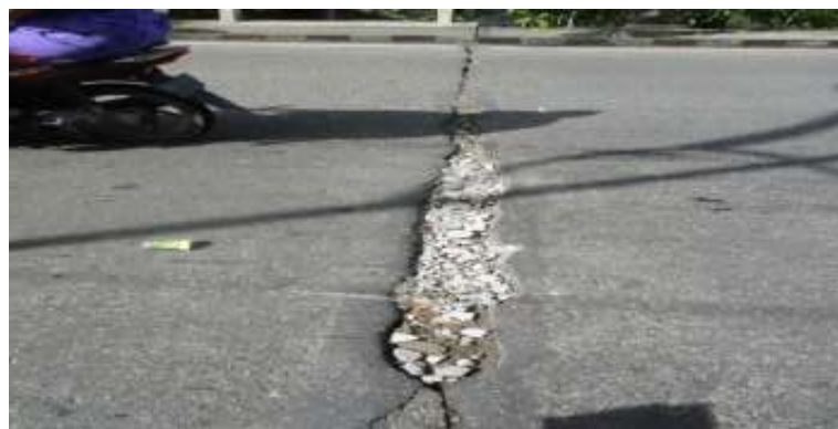
Gambar 2.9. Kerusakan Expansion Joint Jembatan Sebarang Padang 1
