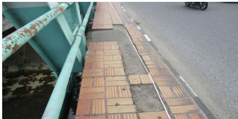
Gambar 2.16. Kerusakan Pada Trotoar Jembatan Andalas B
