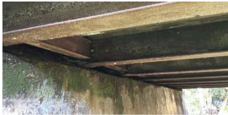
Gambar 2.3. Kerusakan Pada Baja Jembatan Muara Kasang B
