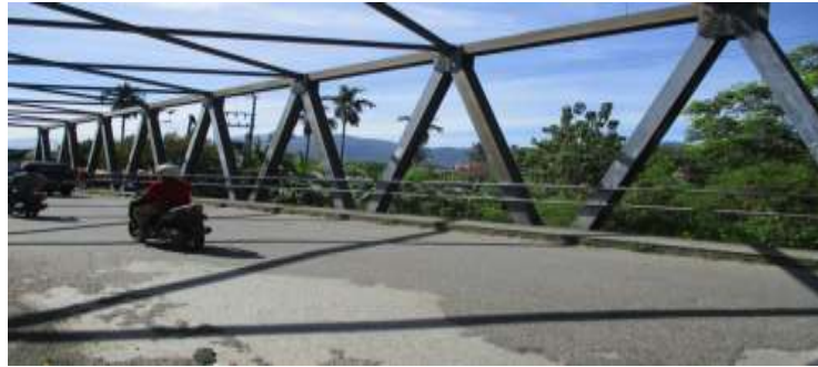
Gambar 2.6. Kerusakan lantai Jembatan Bunuaran
