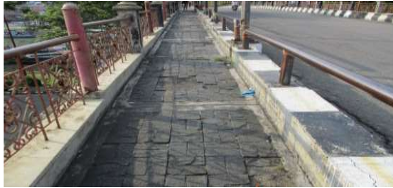
Gambar 2.15. Kerusakan Pada Trotoar Jembatan Siti Nurbaya
