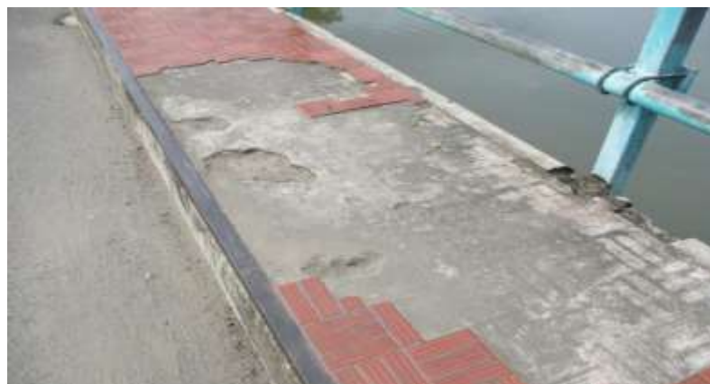
Gambar 2.17. Kerusakan Pada Trotoar Jembatan Sebarang Padang 2
