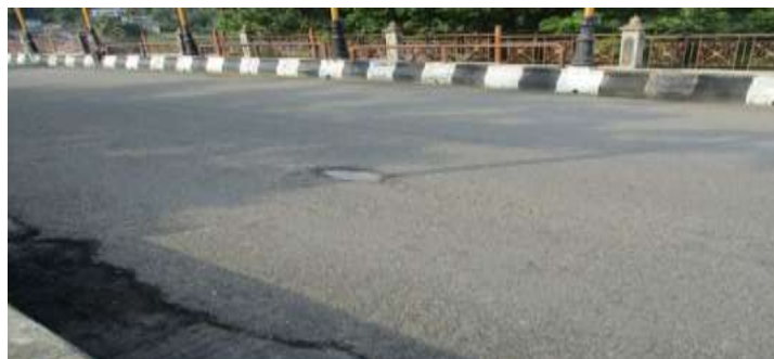
Gambar 2.5. Kerusakan lantai Jembatan Siti Nurbaya
