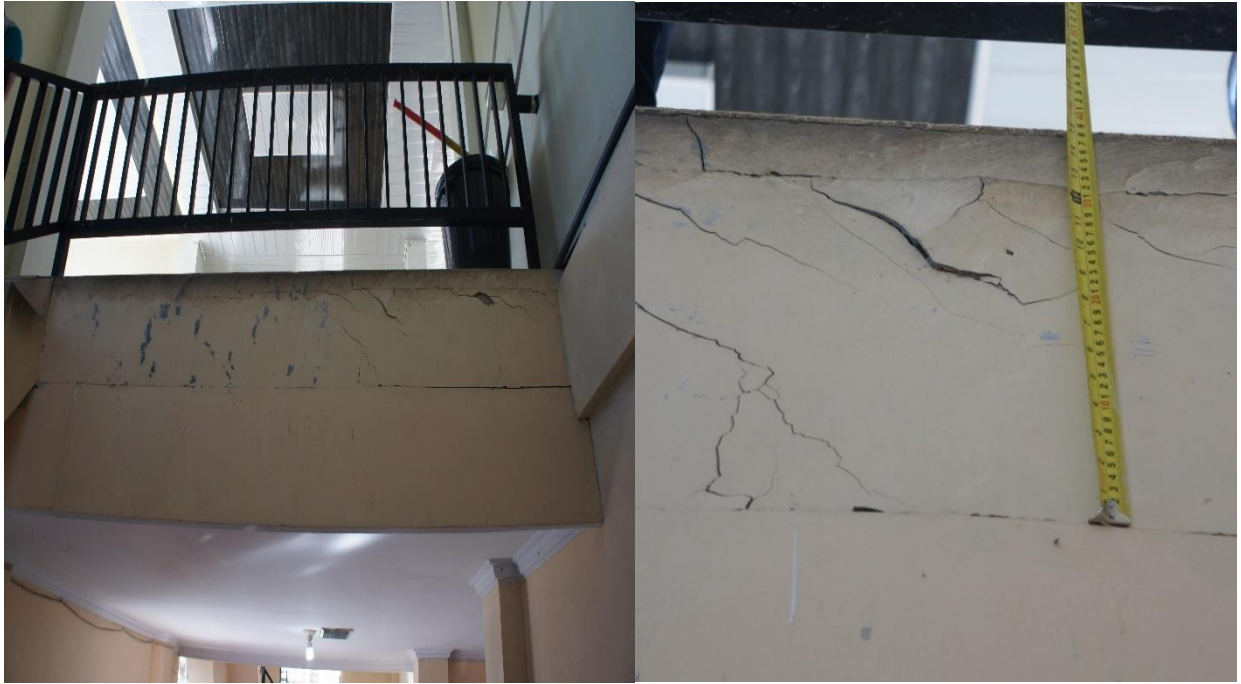
Gambar 15. Retak Lentur dan Geser pada Bagian Balok Tangga Kiri (berbahaya)
