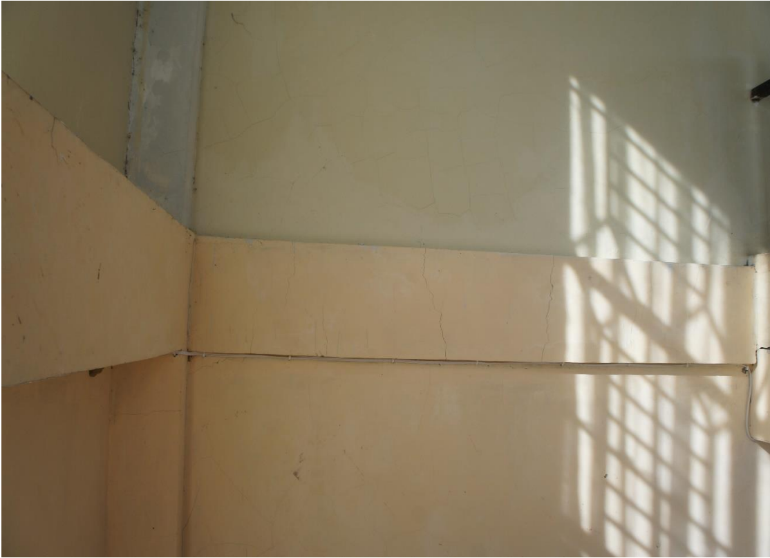
Gambar 13. Retak Lentur dan retak selimut beton pada bagian balok lantai 2 bagian kanan
