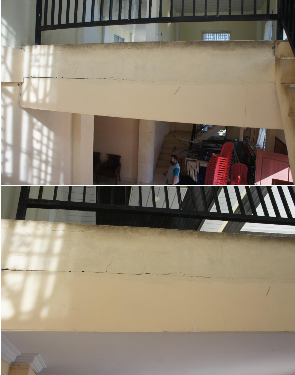
Gambar 14. Retak lentur dan geser yang mengakibatkan terjadi lendutan pada balok
