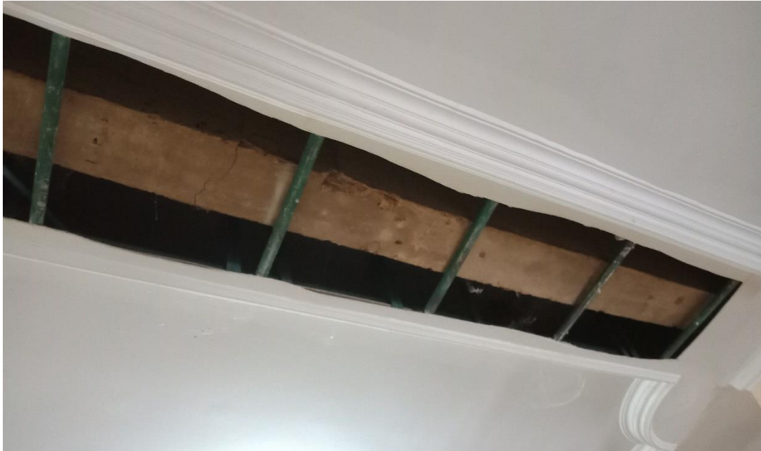
Gambar 17. Retak Lentur dan Geser pada Bagian Balok Lantai 2 bagian tengah
