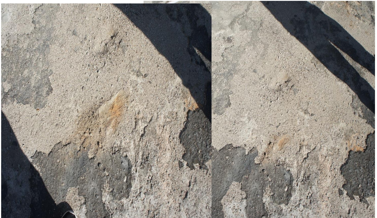
Gambar 18. Beton Lantai bagian Atap Keropos
