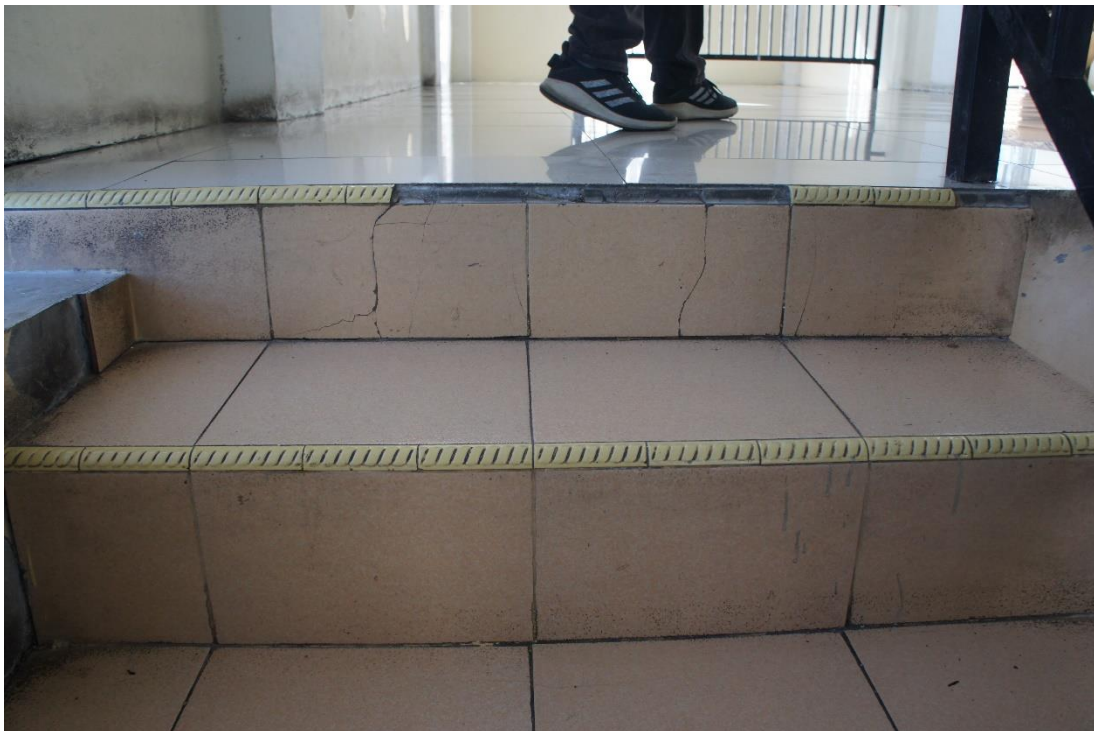
Gambar 16. Retak Lentur dan Geser pada Bagian Balok Lantai Tangga Kiri (berbahaya)
