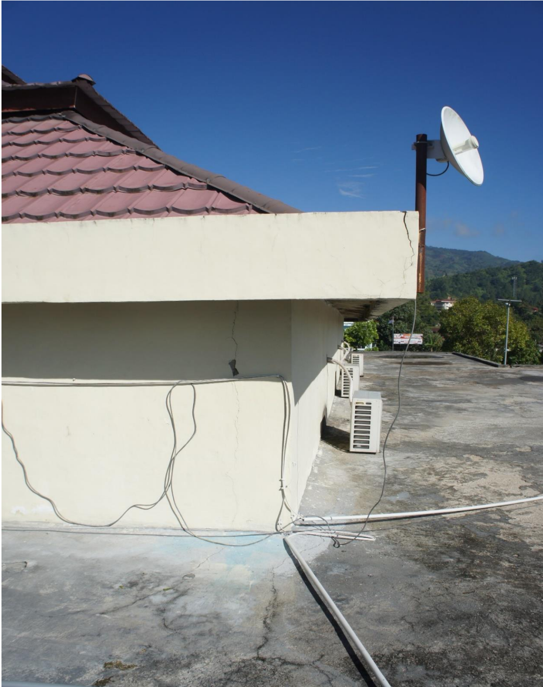
Gambar 19. Pemisahan/retak bagian kolom atap (tidak adanya pengangkuran dan beban atap)
