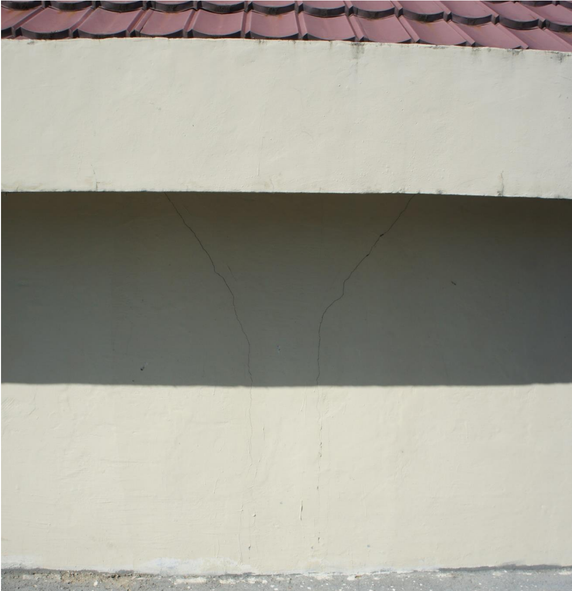
Gambar 20. Pemisahan/retak pada kolom pada bagian atap tidak adanya pengankuran dan beban atap)
