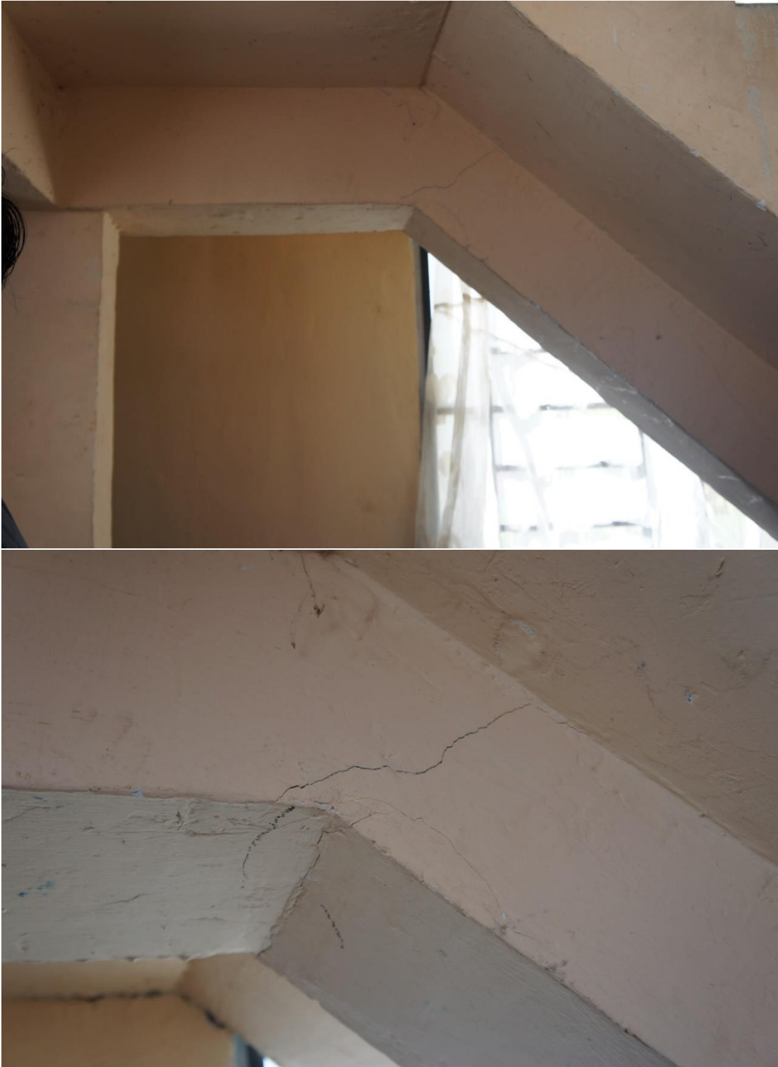
Gambar 21. Retak geser pada ujung balok (sambungan Balok)
