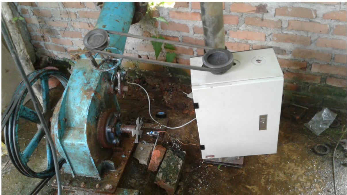
Gambar 5.14. PLTMH Sudah Terpasang GLC
