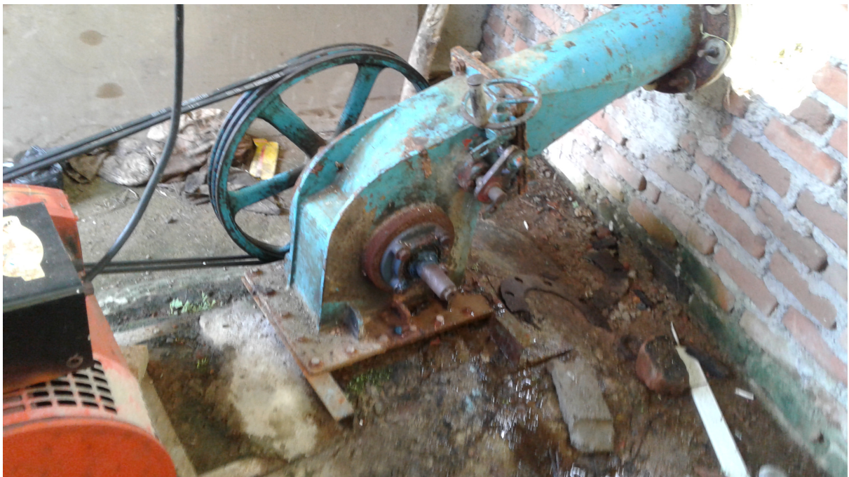
Gambar 5.12. PLTMH Lubuk Tempurung Sebelum Dipasang GLC
