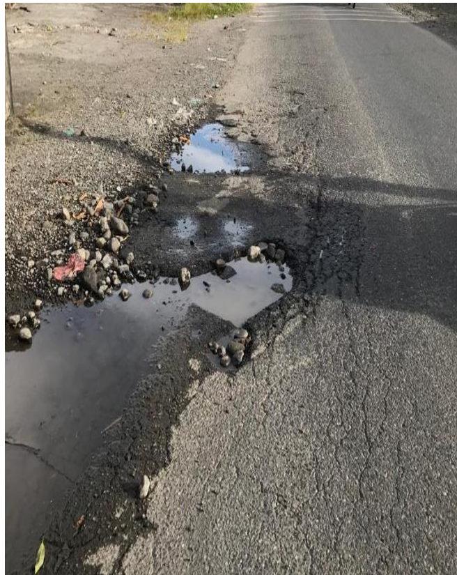
Gambar 1.1 Kondisi Jalan Raya Sicincin – Kurai Taji Pariaman km 58
