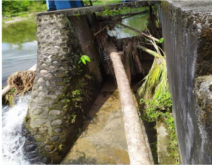
Gambar 1.3 Pintu penguras yang tidak berfungsi lagi
