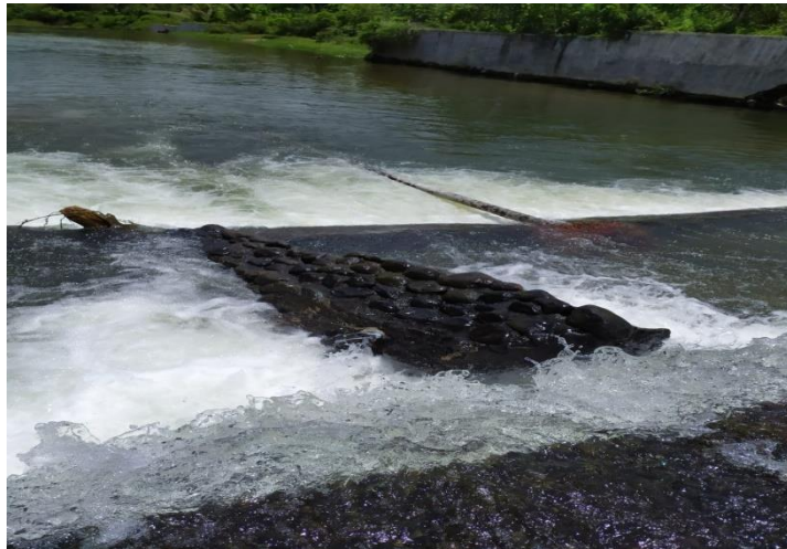
Gambar 1.2 Kolam olak yang sudah rusak
