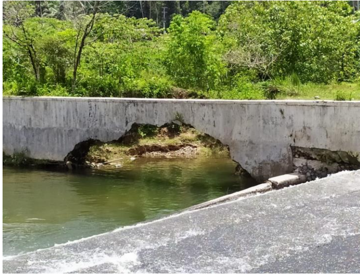
Gambar 1.1 Tubuh bendung yang sudah rusak
