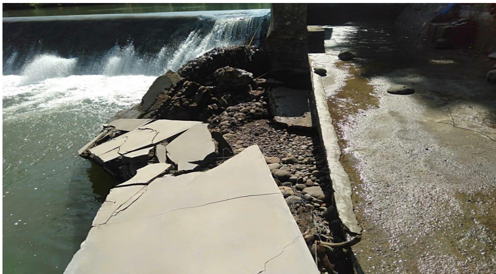
Gambar 1. 2 Kerusakan Saluran Irigasi Sebelah Kiri (Sumber : Dokumentasi Pribadi)
